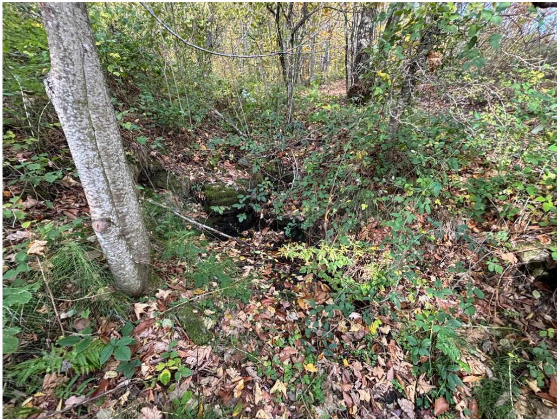
Foto 7: Stato attuale dei luoghi, evidente la necessità di pulire le sponde laterali e di costruire due ali in muratura per migliorare lo scolo delle acque
