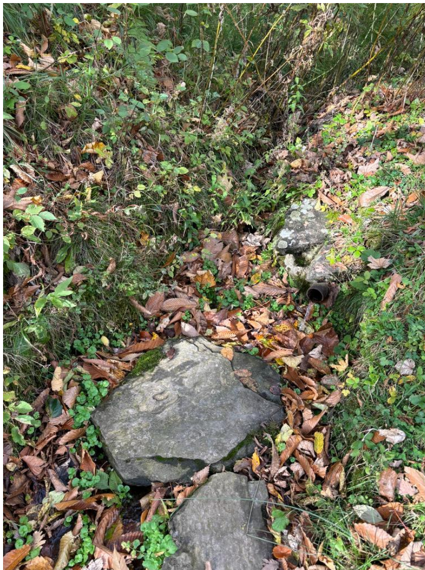
Foto 5: particolare della tubazione di fuoriuscita dell'acqua
