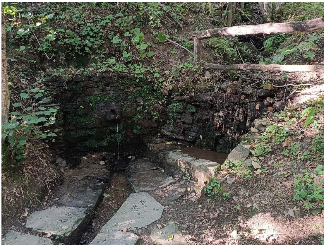
Foto 2: Stato attuale dei luoghi, evidente la necessità del recupero delle murature esistenti
