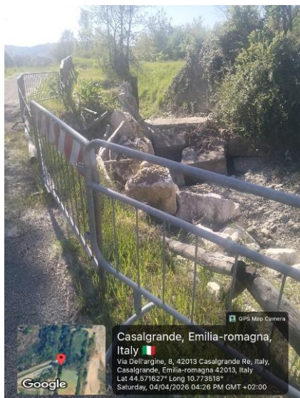
Fig. 9 – Erosione a valle accesso 9
