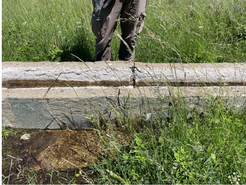
Figura 15 – Tratto di abbeveratoio con crepe e spaccature che determinano perdita di acqua
