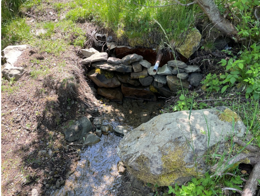
Figura 17 – Punto di captazione idrica (la tubazione di approvvigionamento dell'abbeveratoio è interrata)
