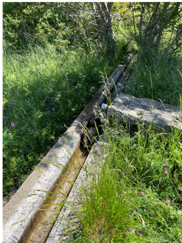
Figura 16 – Punto di immissione idrica con tubo proveniente dalla captazione
