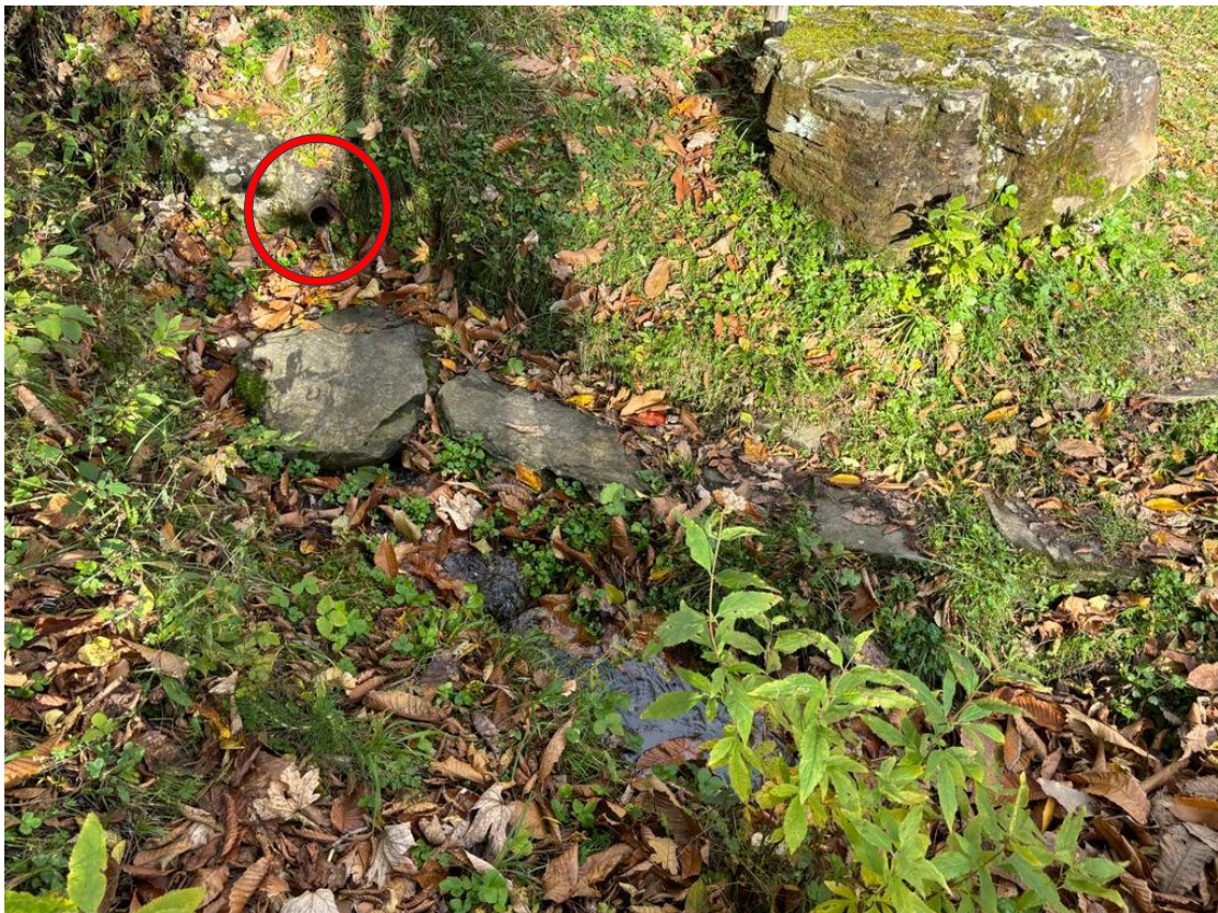
Foto 4: Stato attuale dei luoghi, lastre di pietra da sistemare ed eventualmente sostituire per definire l'accesso alla fontana, nel cerchio evidenziata la tubazione di fuoriuscita dell'acqua
