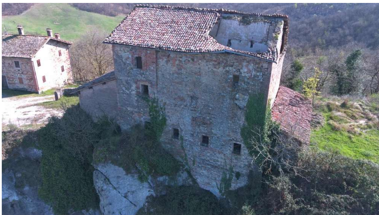
4 -Vista del complesso da nord-ovest. In primo piano il crollo parziale della copertura
