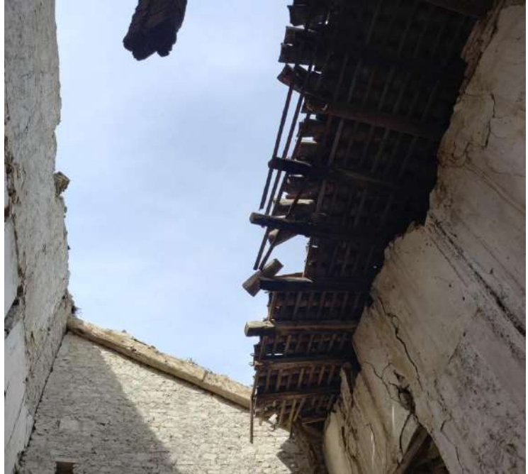
32-Particolare crollo copertura
