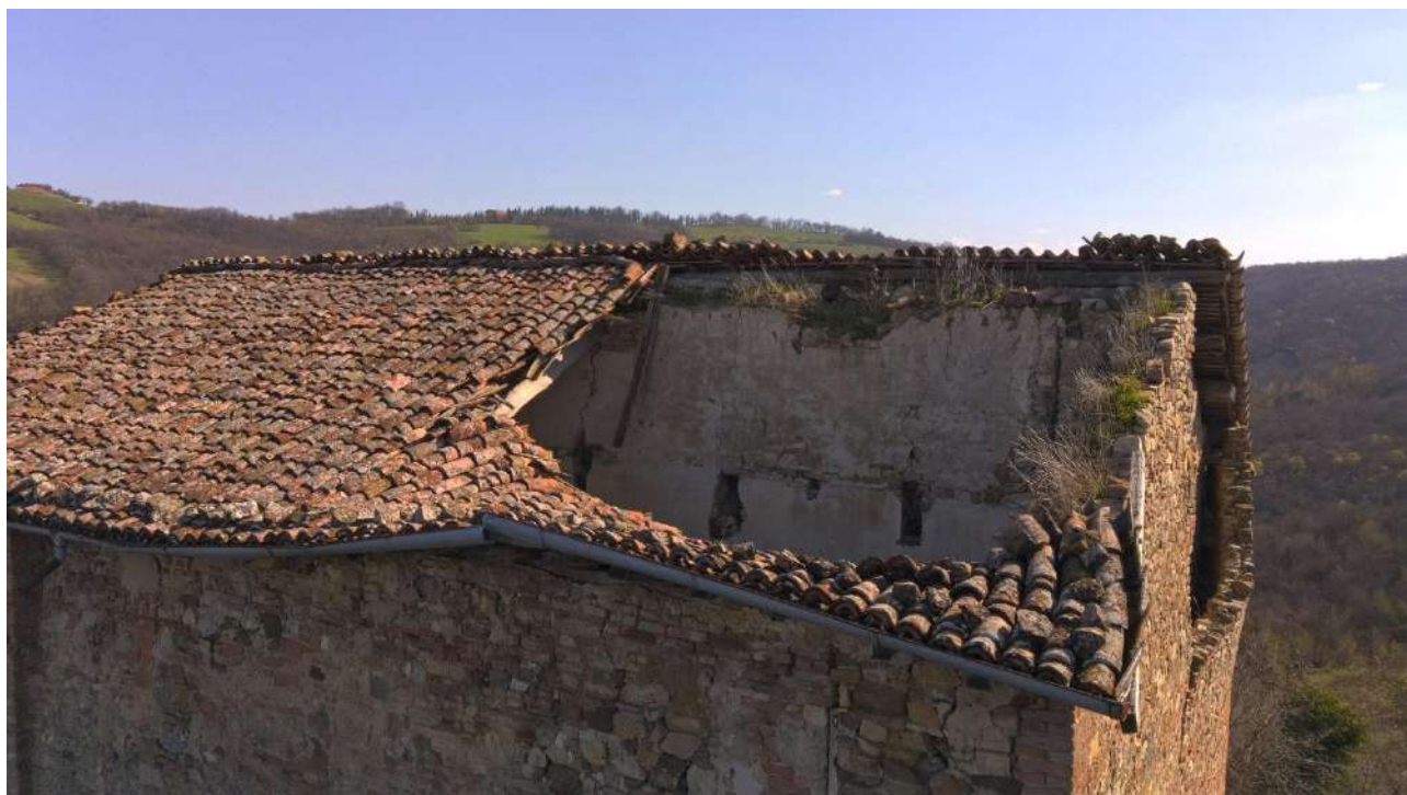
7 --Particolare vista crollo parziale della copertura. Notabile anche il distacco della muratura del fronte ovest.
