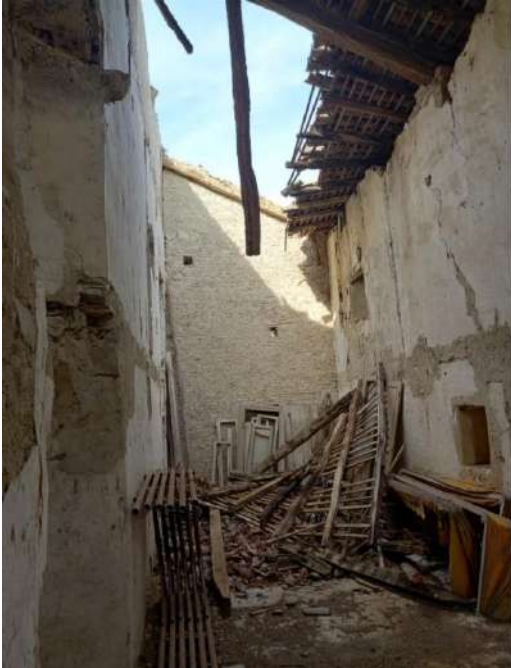
31-Particolare crollo copertura
