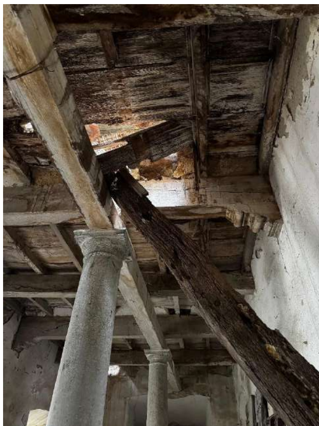
22- Pianoterreno..Particolari dei crolli
