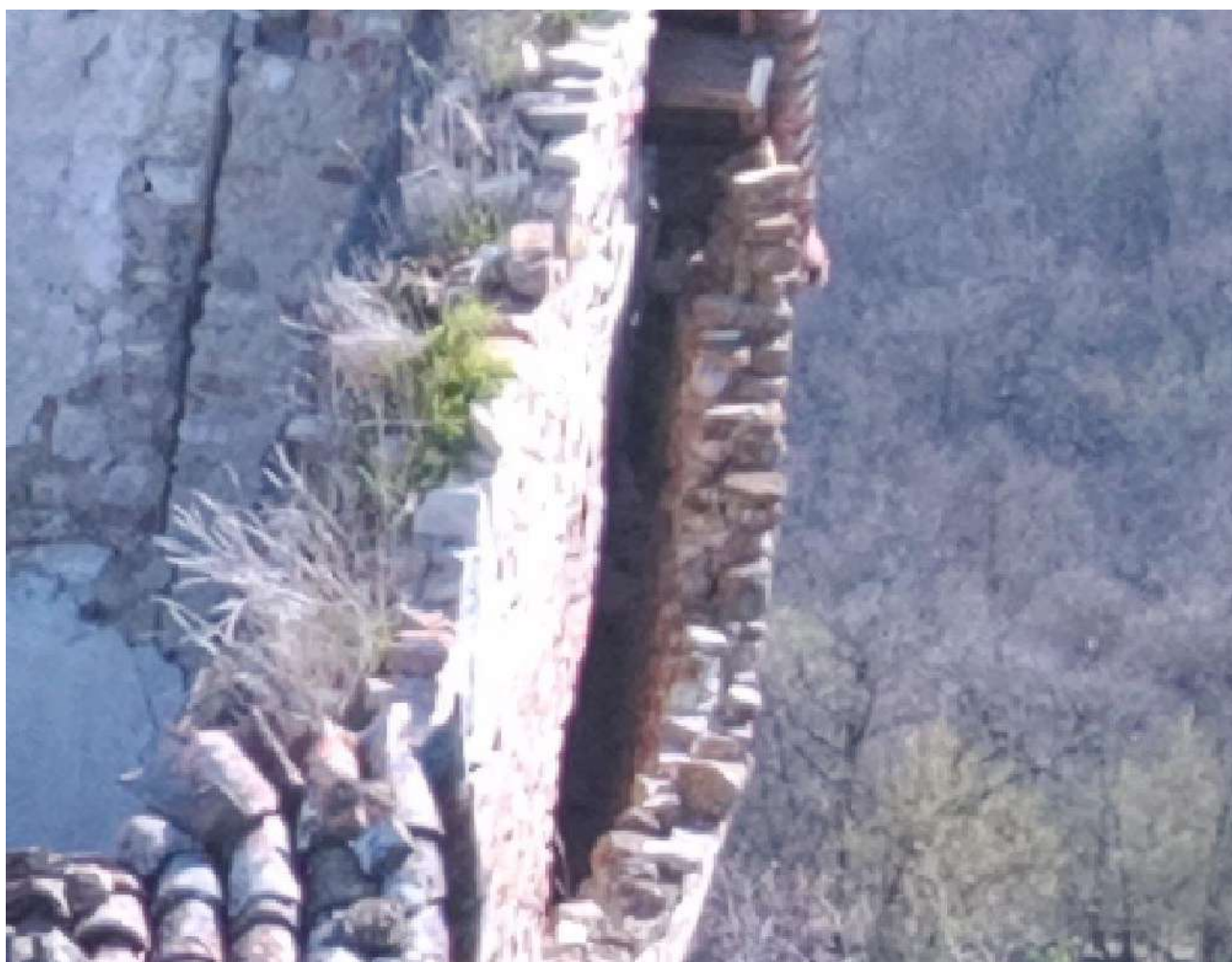
8 -Particolare del distacco della muratura sul fronte ovest del fabbricato
