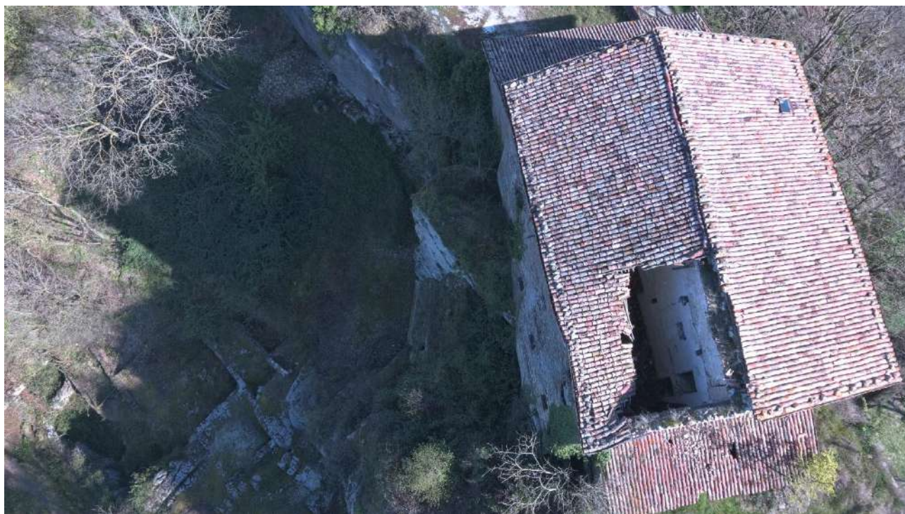
5 -Particolare vista crollo parziale della copertura
