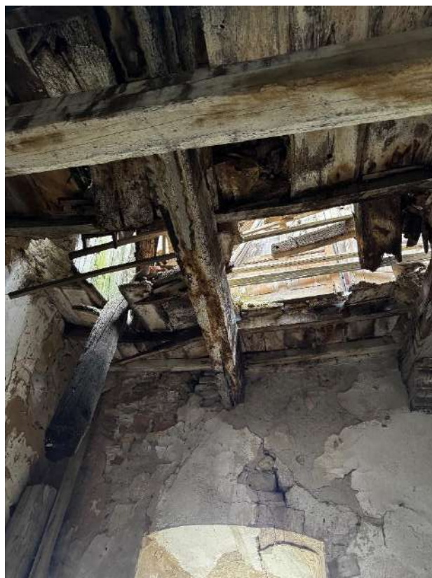
23- Pianoterreno..Particolari dei crolli
