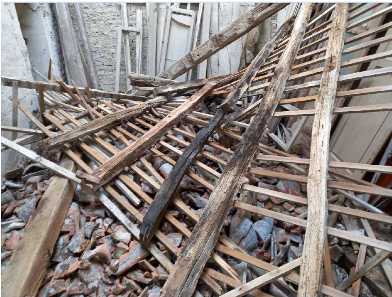
30- Interno. Piano superiore. Crollo della copertura ala nord
