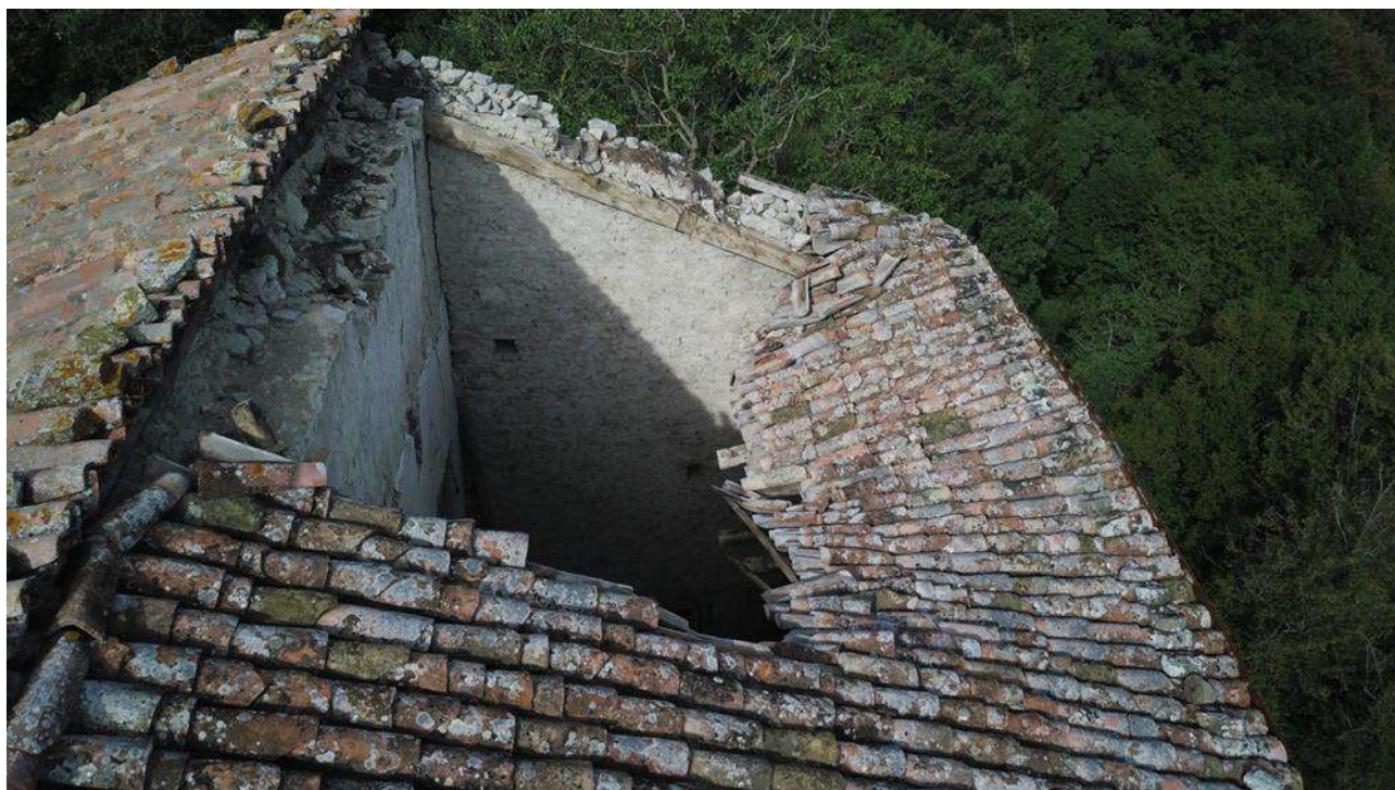
6 --Particolare vista crollo parziale della copertura
