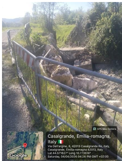
Fig. 9 – Erosione a valle accesso 9
